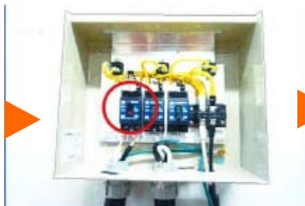
接続箱内のブレーカ ON
